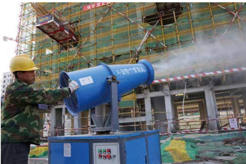
► 2017年11月5日， 在山东省滨州市博兴县 一处建筑工地，一名建 筑工人操作“环保除尘 雾炮机”降低施工现场 扬尘污染。(陈彬摄)
