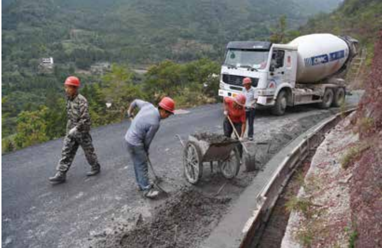
► 2016年10月10日，施工人员在重庆市巫山县南大路(南陵乡到大溪乡)现场进行施工。 (新华社记者陈诚摄)
